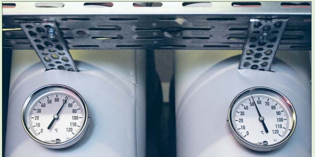
Nahwärmernetze arbeiten heute noch mit recht hohen Temperaturen (im Bild eine Heizzentrale: Vorlauf ins Heizungsnetz links, Rücklauf rechts). Ein neues Netzkonzept soll helfen, die Vorlauftemperaturen und damit die Wärmeverluste sowie die Kosten deutlich zu senken. Foto: Heinz Wraneschitz
